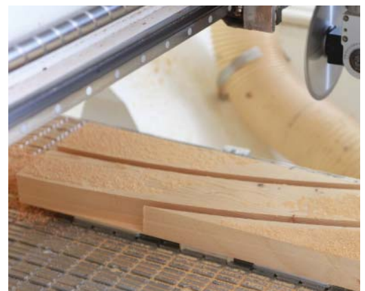
Das CNC-Bearbeitungszentrum fräst das Holz 3-dimensional und hat einen Abweichungswert von nur 0,003 Millimetern. Sie wiegt 2,5 Tonnen.
